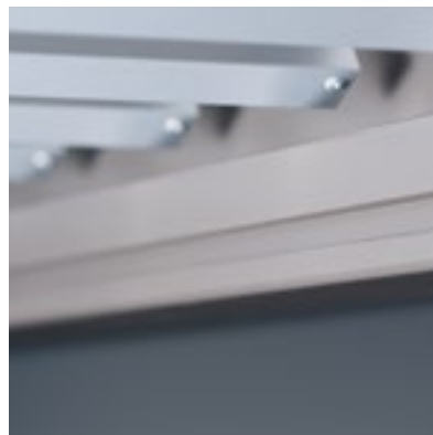
03 Vorbereitung für LED-Beleuchtung (Kanal mit Abdeckung)
