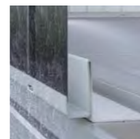
Zábrana proti dažďovej vode
