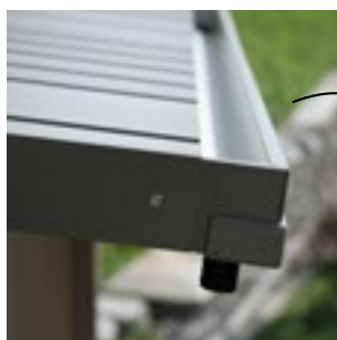
Elülső oldali beépített esőcsatorna.
